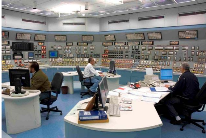
Sala de controle da usina Angra 1
